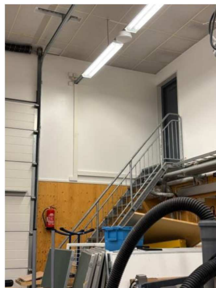
Kuva 4 Iv-konehuoneeseen vievät portaat ovat erittäin jyrkät
